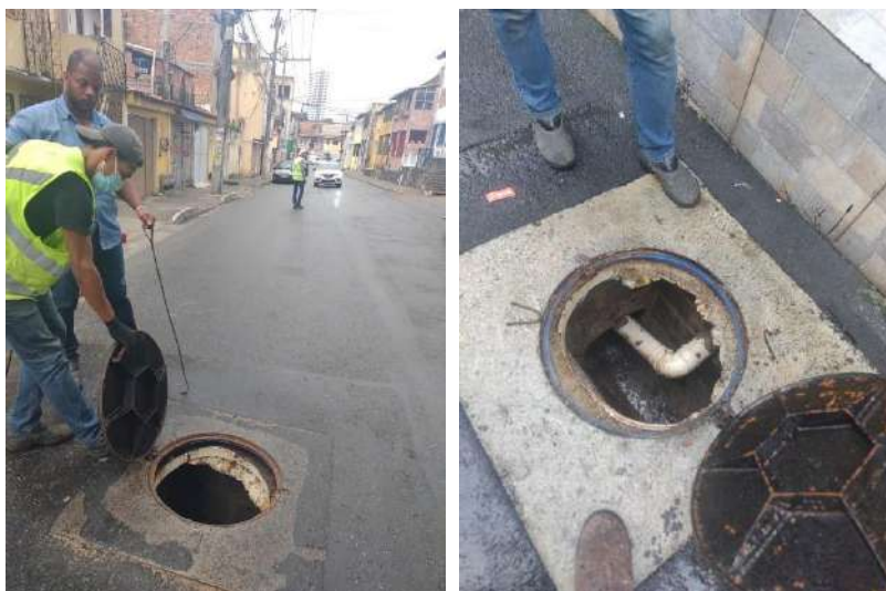
Figura 10 – Execução dos serviços de campo na rua São Gonçalo em São Gonçalo do Retiro
