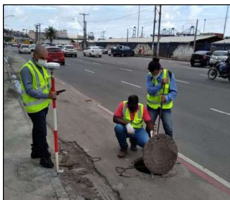
Figura 8 – Execução dos serviços de campo com abertura de poços de visita – Av. Engenheiro Oscar Pontes
