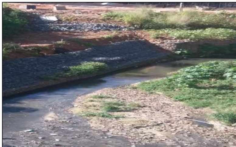
Figura 8 – Situação do Trecho T11 verificada em visita técnica realizada em julho/2021
